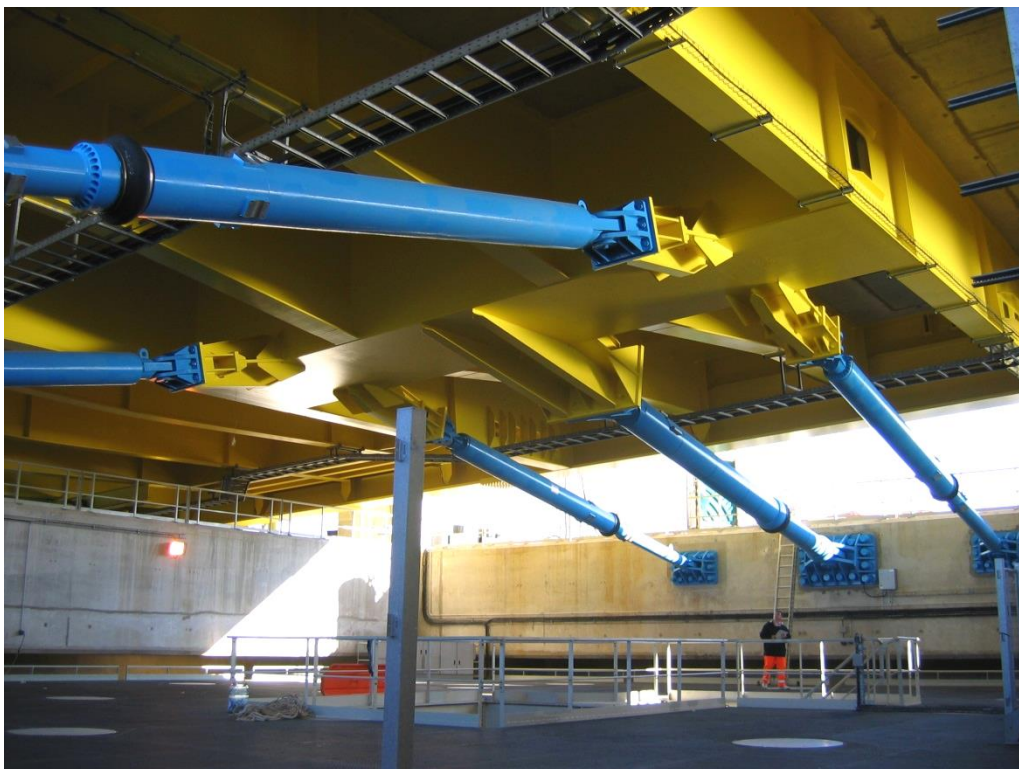
Figura 6 – Dissipatori viscosi e fusibile installati nel ponte Rion-Antirion in Grecia
