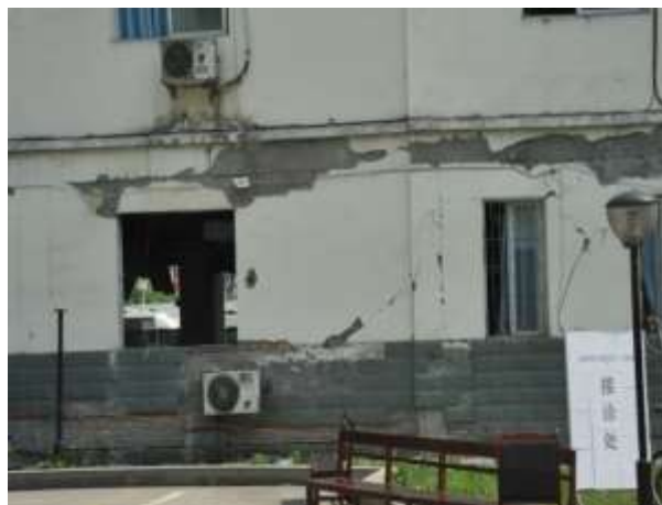
Figura 6 - Danni causati dal terremoto di Lushan alle strutture portanti dei due edifici fondati convenzionalmente dell'ospedale di Figura 2 e 3 [5]
