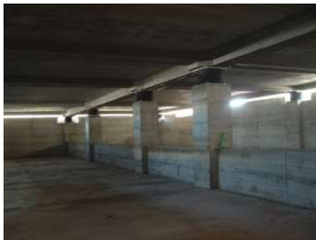
Figura 5 – Alcuni degli isolatori elastomerici che proteggono la scuola di Galliciano di Figura 4
