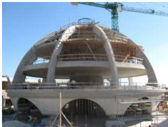
Figura 9 – Vista di fronte dell'edificio principale del Centro Operativo e Formazione di Figura 8, sorretto da 10 isolatori elastomerici ad alto smorzamento di 1 m di diametro, realizzati dalla società FIP Industriale
