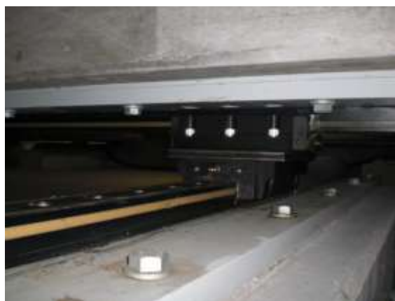
Figura 2 – Alcuni isolatori a ricircolo di sfere ed una coppia di isolatori elastomerici sovrapposti (con funzioni di ricentraggio) del sistema di isolamento sismico del tempio di Figura 1
