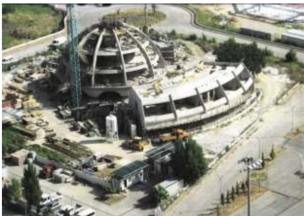
Figura 8 – Vista dall'alto dell'edificio principale e di quello attiguo, ambedue isolati simicamente, del Centro Operativo e Formazione, in costruzione nel nuovo Centro della Protezione Civile di Foligno (estate 2009). Gli edifici sono stati progettati dal Prof. Parducci; lo scrivente fa parte delle commissioni di collaudo in corso d'opera statico ed amministrativo
