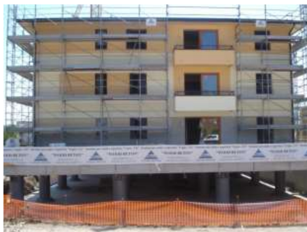
Figura 13 – Uno dei prefabbricati in costruzione nell'area de L'Aquila sulle piastre isolate similmente di Figura 11 (estate 2009)
