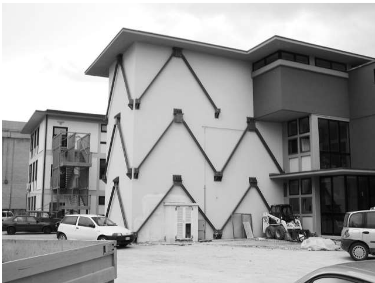
Figura 5 – Scuola Gentile Fermi di Fabriano Potenza – Esempio di applicazione della dissipazione d'energia (dissipatori viscoelastici)
