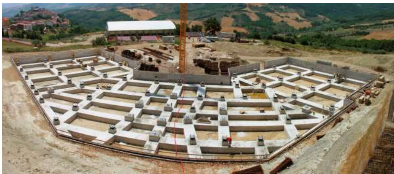
Figura 3 – Isolatori installati sulle fondazioni della nuova scuola Francesco Jovine e del Centro Professionale ed Universitario “Le Tre Torri” di San Giuliano di Puglia
